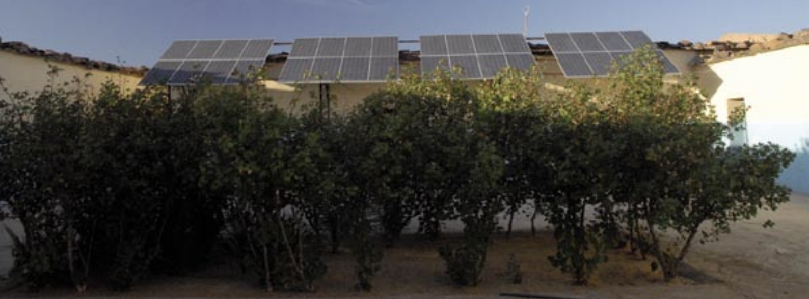
> Impianto fotovoltaico sull'ospedale di Dakhla
